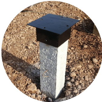
ЖБ свая с металлическим оголовком
